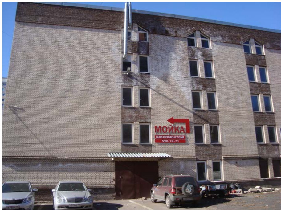
Рис. 6 Следы выщелачивания раствора
