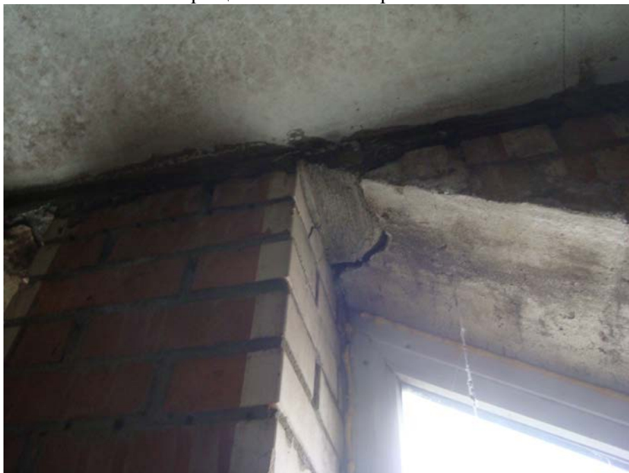
Трещины в бетоне перемычек
